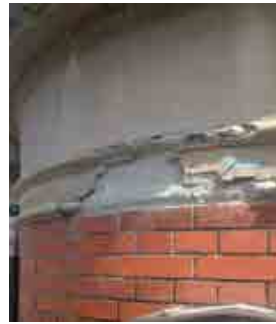
【凝灰岩装飾部劣化状況】
