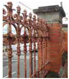
【袖塀劣化状況】
